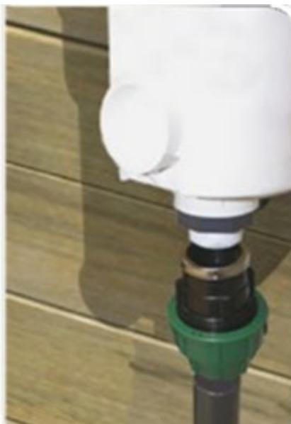
Starres abfallendes Rohr unter dem Skimmer
